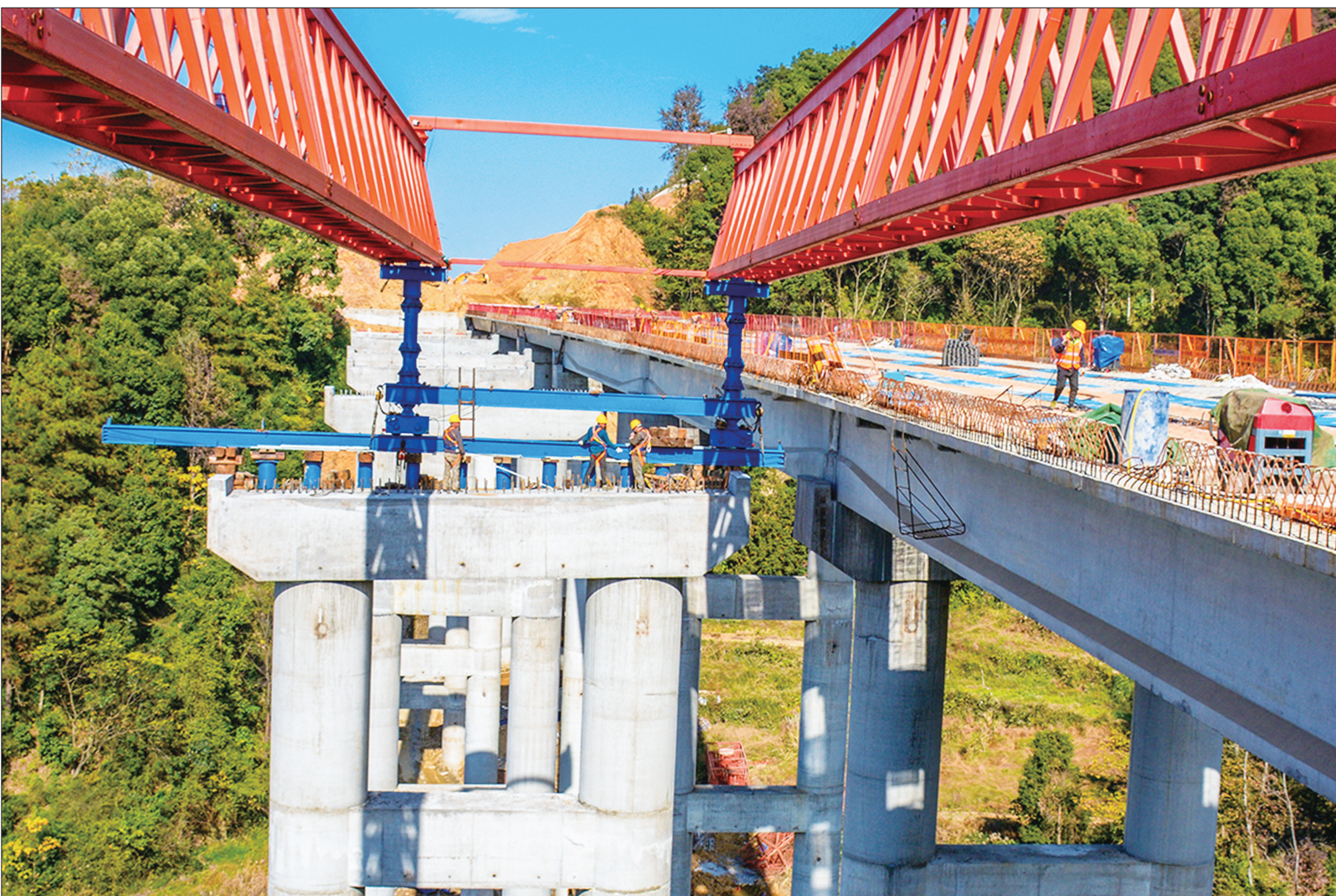
12月15日,新宁县金石镇观瀑村,新新高速公路二标段二工区观瀑1号高架桥上,工人们正在施工作业。目前,该大桥已经完成单向铺设箱梁,进入双向铺架施工,预计本月底前完成。
