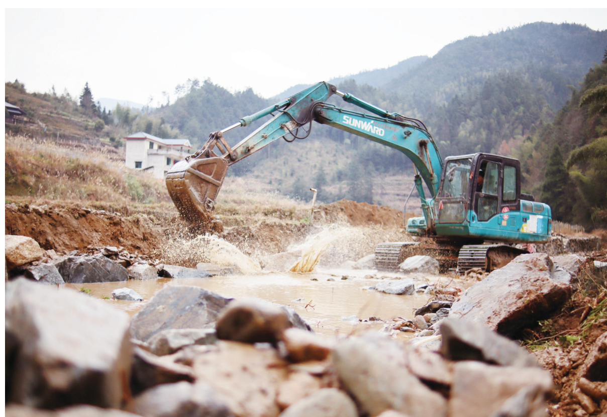
12月17日,城步苗族自治县汀坪乡汀坪村大岔自然片,一台挖掘机在修筑河堤现场进行施工作业。入冬以来,汀坪村通过“集体出资+村民筹劳”的方式修建河堤,确保了河道旁稻田不受洪水影响。严钦龙 陈科帆 摄影报道
