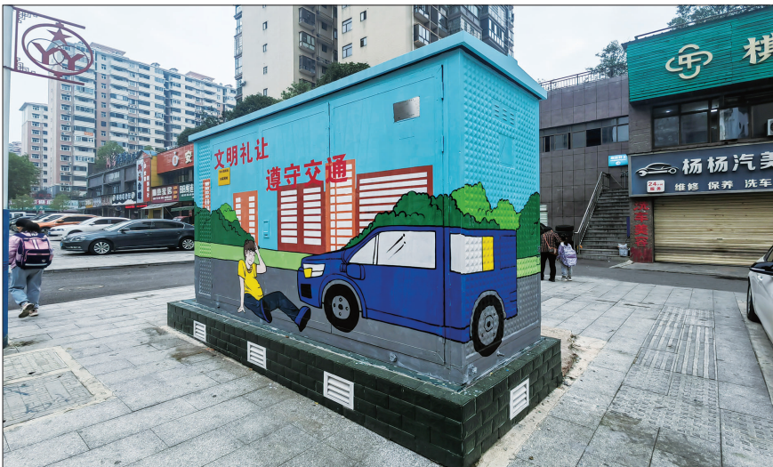
近段时间,大祥区雪峰南路沿线人行道上摆放的变压器配电箱都换上了“文化装”,原本锈迹斑斑影响市容的配电箱焕然一新,成为街道一道靓丽风景线。 邵阳日报记者 伍洁 摄
