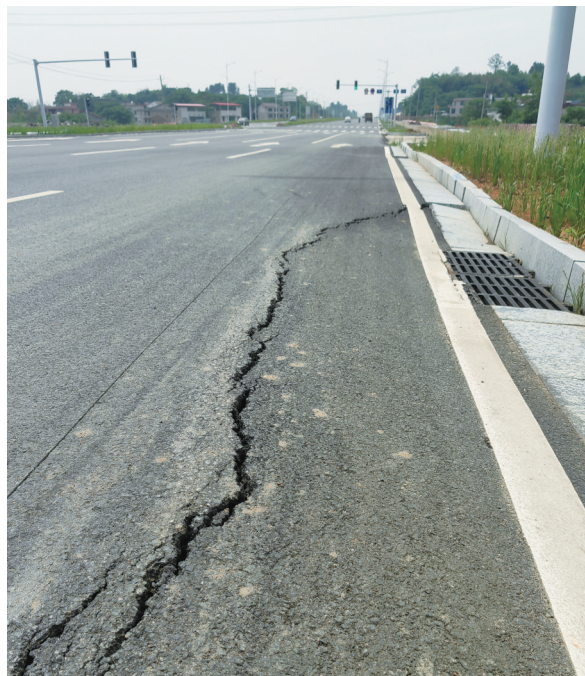
市区邵西大道有数处路面塌陷开裂,存在安全隐患,希望有关部门尽快修复好。 邵阳日报记者 伍洁 摄
