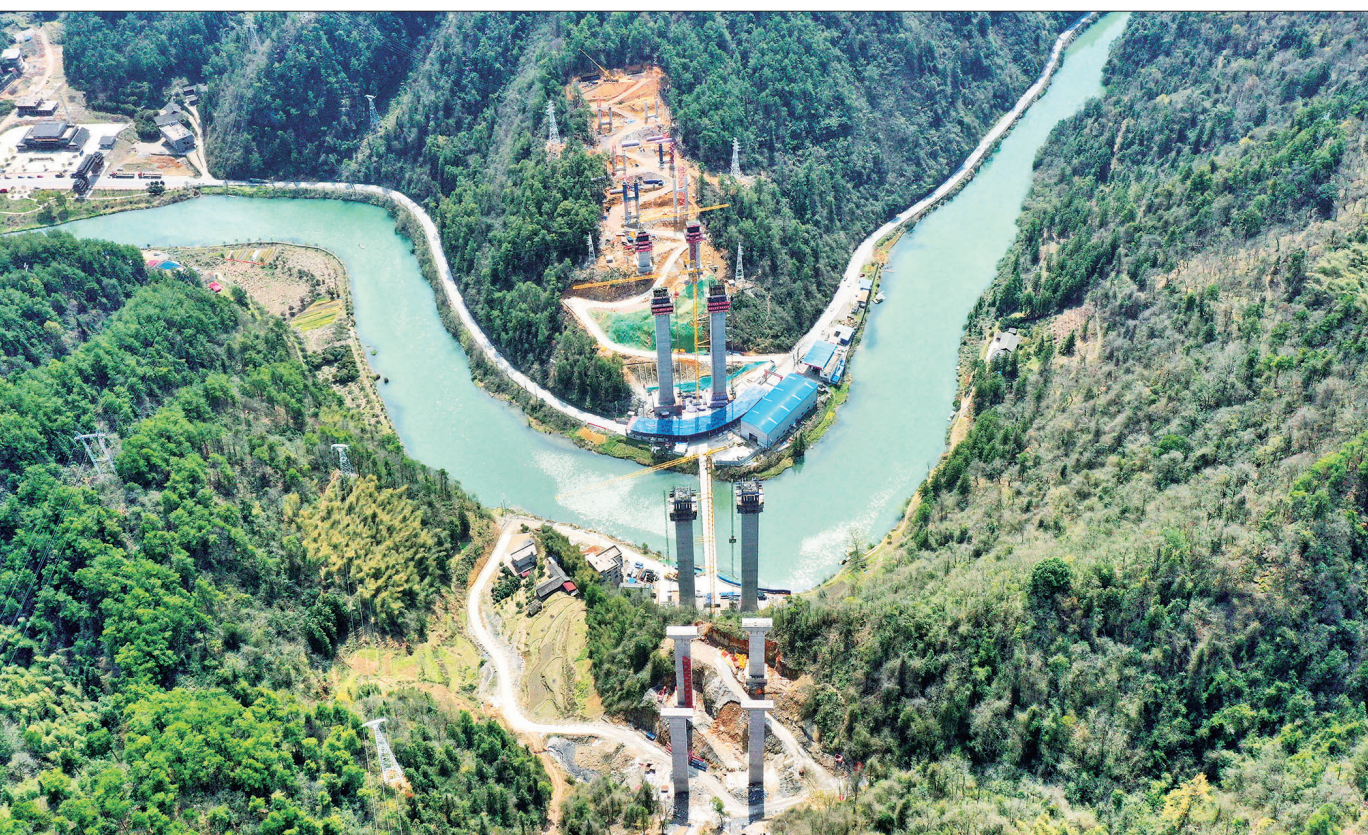
3月19日,航拍建设中的城龙高速湖南段落叶湾巫水特大桥。该桥位于城步儒林镇城南村,采用1孔主跨方式进行建设,土建造价约1.33亿元。目前,已完成桥梁桩基的施工,主墩全部封顶。立柱完成80%,空心薄壁墩完成90%。
