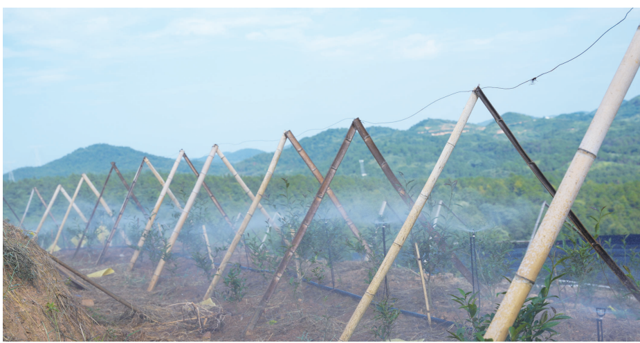
新安装的自动喷灌系统正在给茶树浇水。邵阳日报记者 唐明业 摄
