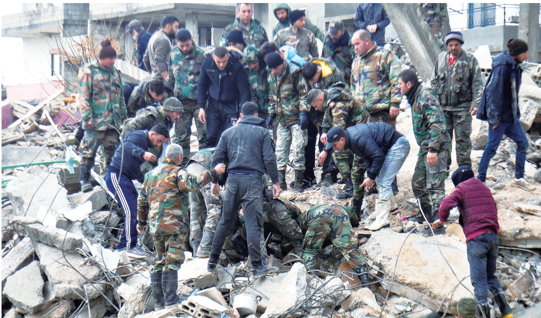
2月6日,在叙利亚拉塔基亚省杰卜莱,人们在一处倒塌的建筑现场进行救援。 新华社发
