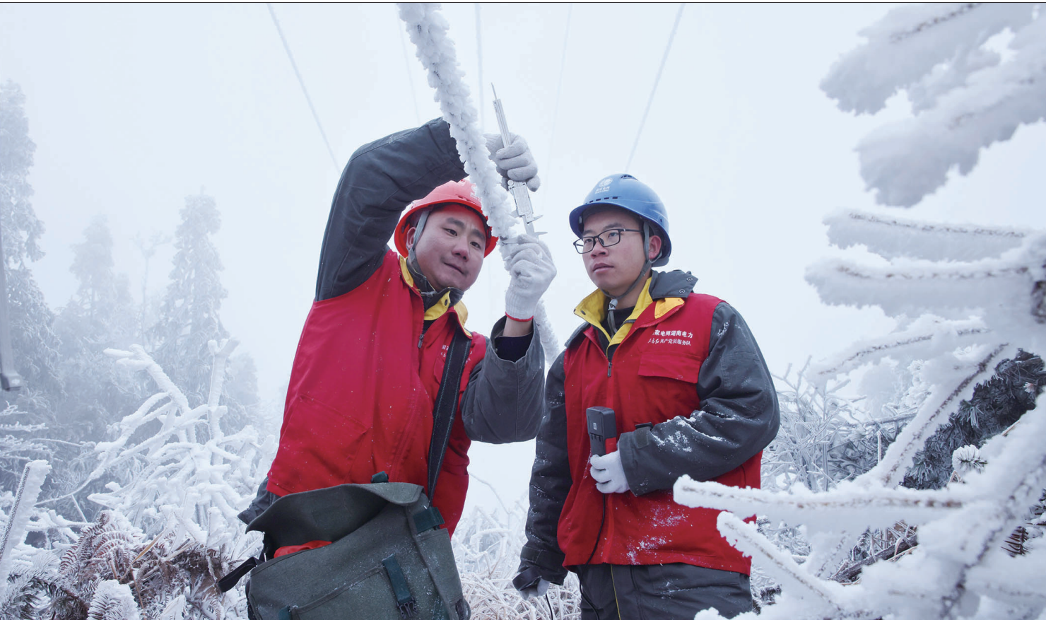
近日,我省迎来低温冰冻天气过程,隆回县北部高海拔山区和微地形区域有中等程度覆冰。为确保供电稳定,国网邵阳供电公司在全市优化部署237支应急抢修队伍2316人、338台应急车辆、4台发电车,做好应急值守、观冰巡线、设备巡视等电力保供工作,全力确保电网运行平稳和广大客户供电需求。
