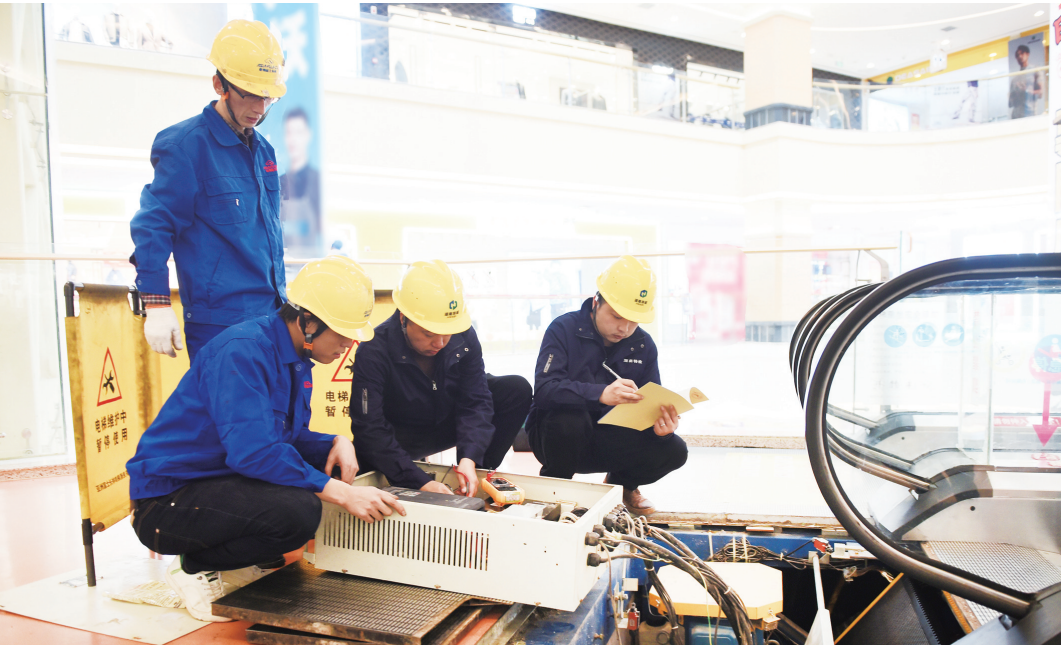
为保障人民群众生命财产安全,加强电梯安全监管,近日,省特检院邵阳分院对市区电梯开展年度检验。图为1月6日,省特检院邵阳分院在维保公司配合下一起对市区一家商场电梯进行检验。 邵阳日报记者 申兴刚 通讯员 尹志宇 摄影报道
