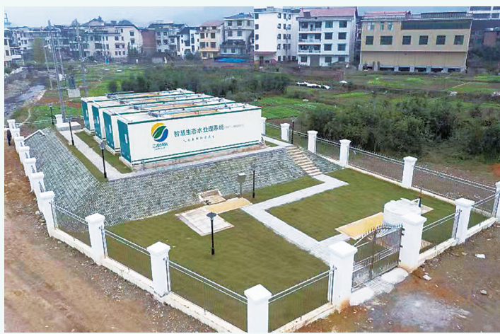
新邵县坪上镇的1000吨智慧生态污水处理系统。
