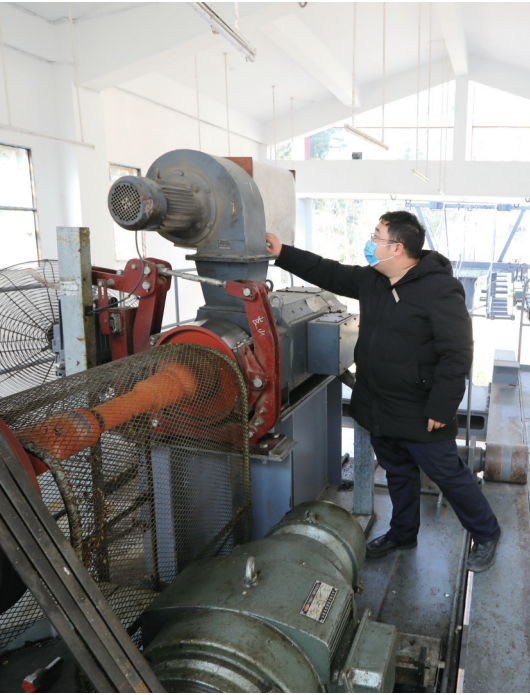
▲索道站重点设备安全运行检查。
