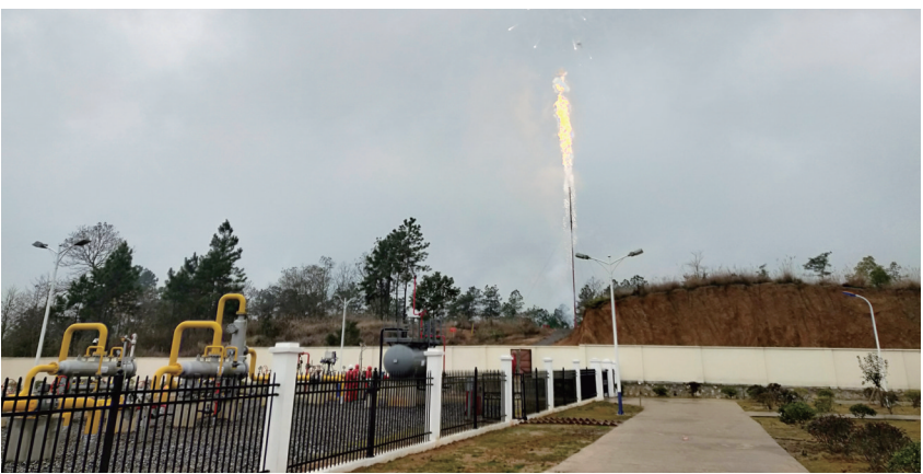
上月28日,“气化邵阳工程”邵东输气管道末站成功点火,标志着“气化邵阳工程”一期正式投产运行。 邵阳日报记者 刘波 摄
