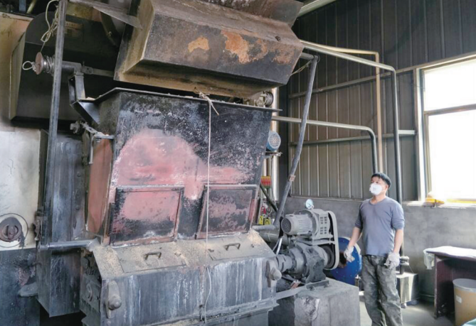
▲宝东农牧锅炉房内,工作人员正在查看生物质锅炉运行情况。
