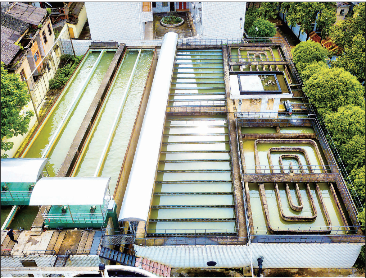
7月11日,市区城西水厂沉淀池在正常生产。该水厂担负着大祥区和江北开发区大部分地区的供水任务,现日供水能力达10万吨。汛期以来,市自来水公司全部人员在岗加强值守,增加对各水厂出厂水的检测频次,确保出厂水质完全符合国家饮用水标准。
