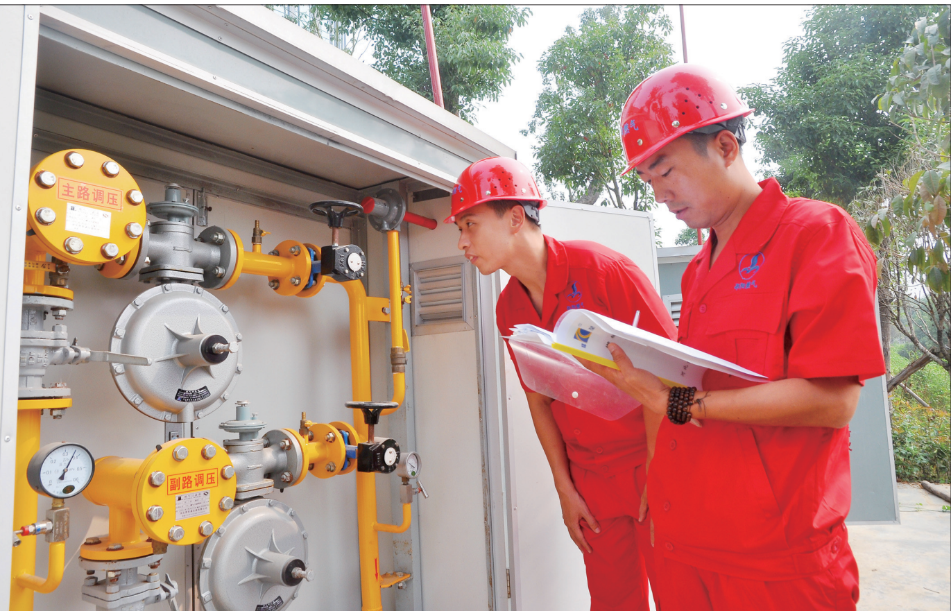
为了保障党代会期间会场与宾馆的燃气供应,市燃气公司200余名职工全力做好服务工作,并有30余名抢修人员24小时在会场周边及沿线值守,以保障燃气供应与安全。图为9月27日,燃气值班人员正在温德姆酒店检查燃气调压箱。 申兴刚 郭巧艳 摄影报道
