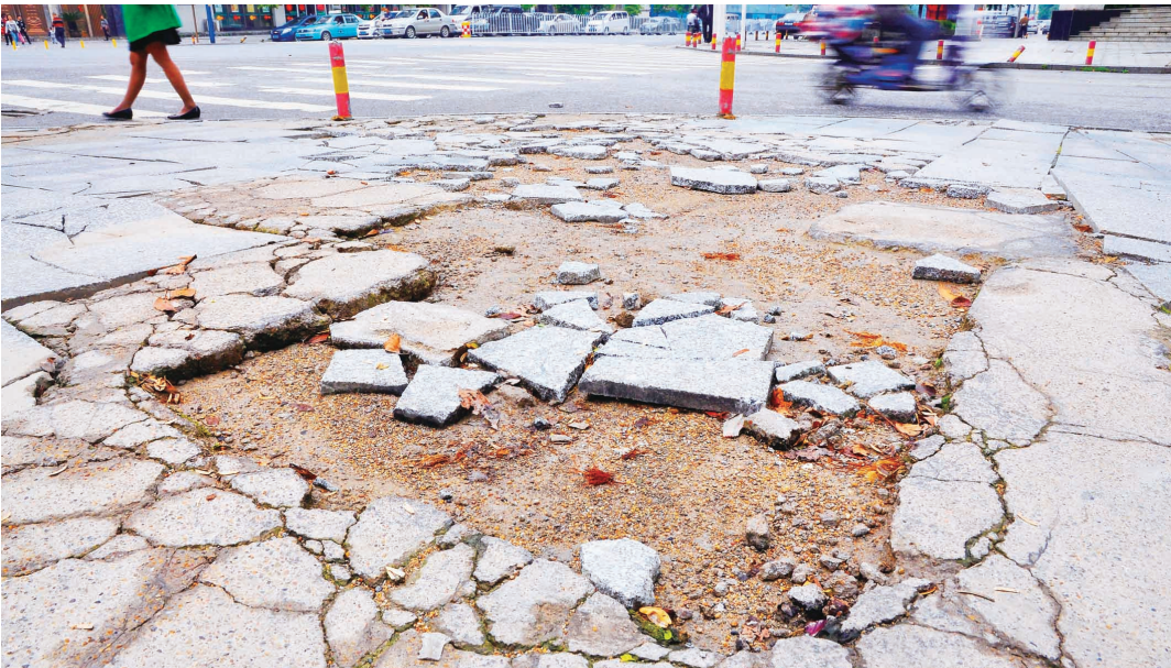
市区敏州东路三和星瑶门口人行道板破损严重。
