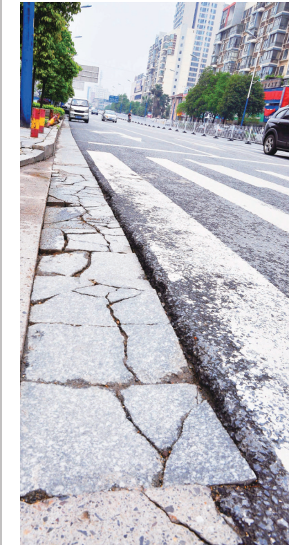
敏州东路元亨圆门口路砖破损。
