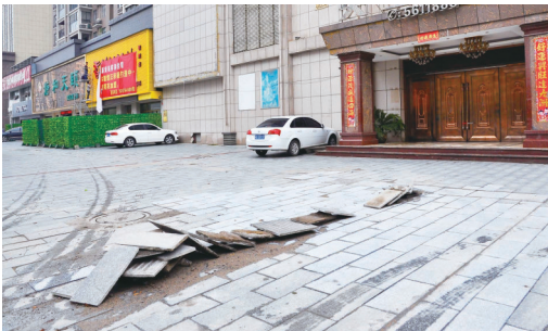
敏州东路英皇国际附近部分人行道板已更换，还有多处破损路面尚未修复。
