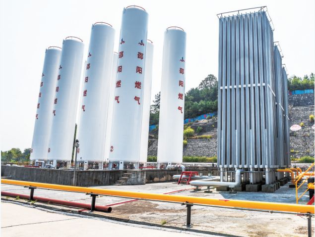
市天然气站天然气储罐。 申兴刚 摄
