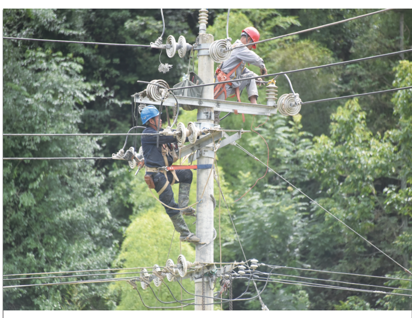
6月8日,一场突如其来的特大暴雨,使绥宁县金屋塘镇电力设施遭受严重破坏,国网绥宁县供电公司组织抢修人员第一时间奔赴现场,采取24小时轮班模式,争分夺秒抢修受损电力设施。 孙芳华 黄信 摄影报道
