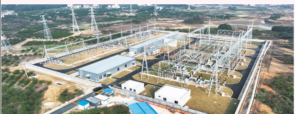
城北(雪峰)220千伏变电站。滕绍沂 摄
