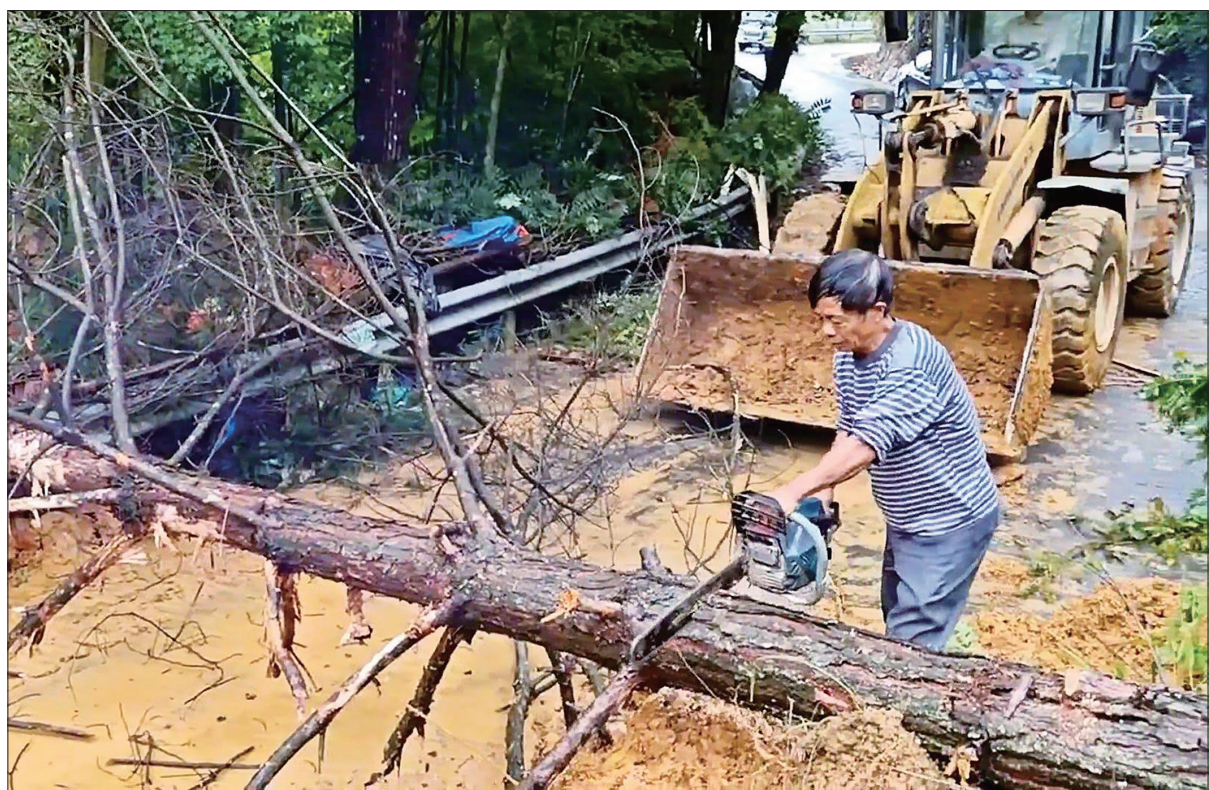
6月30日凌晨开始，绥宁县普降大到暴雨，致使通往麻塘苗族瑶族乡的S342河口至麻塘路段受灾严重，多处塌方，交通中断。该县公路建设养护中心快速调集救援突击队赶往现场实施救援，联合县人武及乡镇人员全力抢险，经过4个多小时的全力奋战，该线路陆续开始恢复通车。 孙芳华 黄宇 肖莉君 摄影报道
