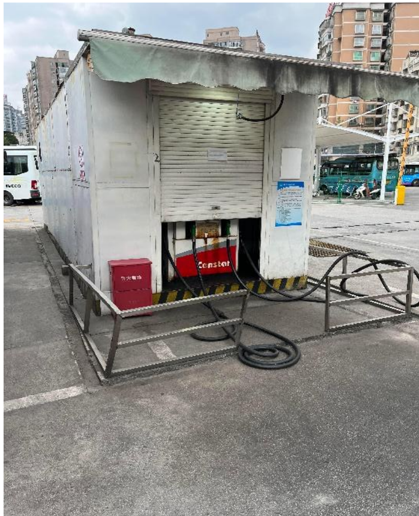
西部某省一地级市客运总站内的一个撬装罐。新华社记者 摄
