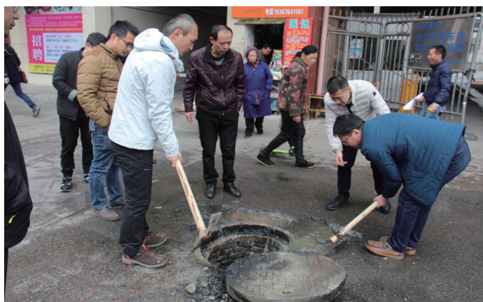
12月1日,市政公司派工作人员来到人民广场扬子巴士四公司门口,查找下水井盖冒脏水的原因。 童中涵 摄
