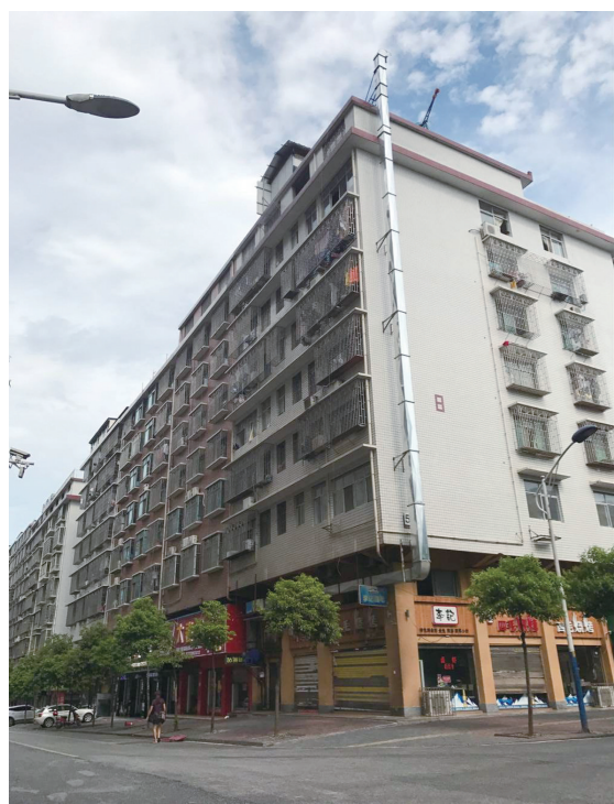
整改后安装的排气管道
