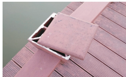
小桥护栏被破坏。
