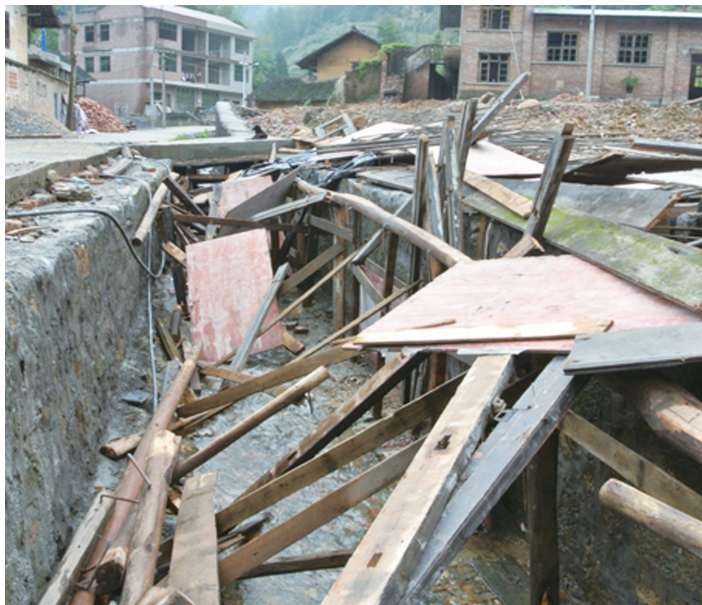
未经审批搭建的盖板,成为村民心中的一大安全隐患。
