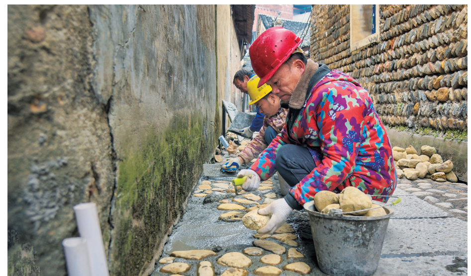
1月1日，建筑工人在武冈市西直街庆丰老巷施工作业。近年来，该市对西直街历史文化街区进行全面保护与提升，采用“微改造、微更新”的方式，完成沿线房屋的保护性修缮。 曾晓红 摄
