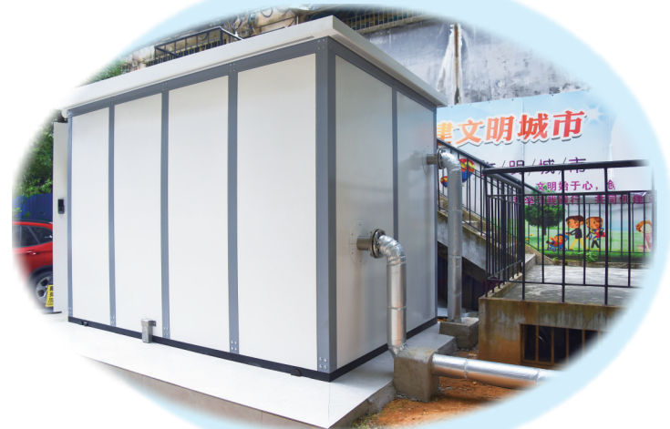
▲市公安局三号家属院内新建的一体化智慧二次供水加压泵房。
