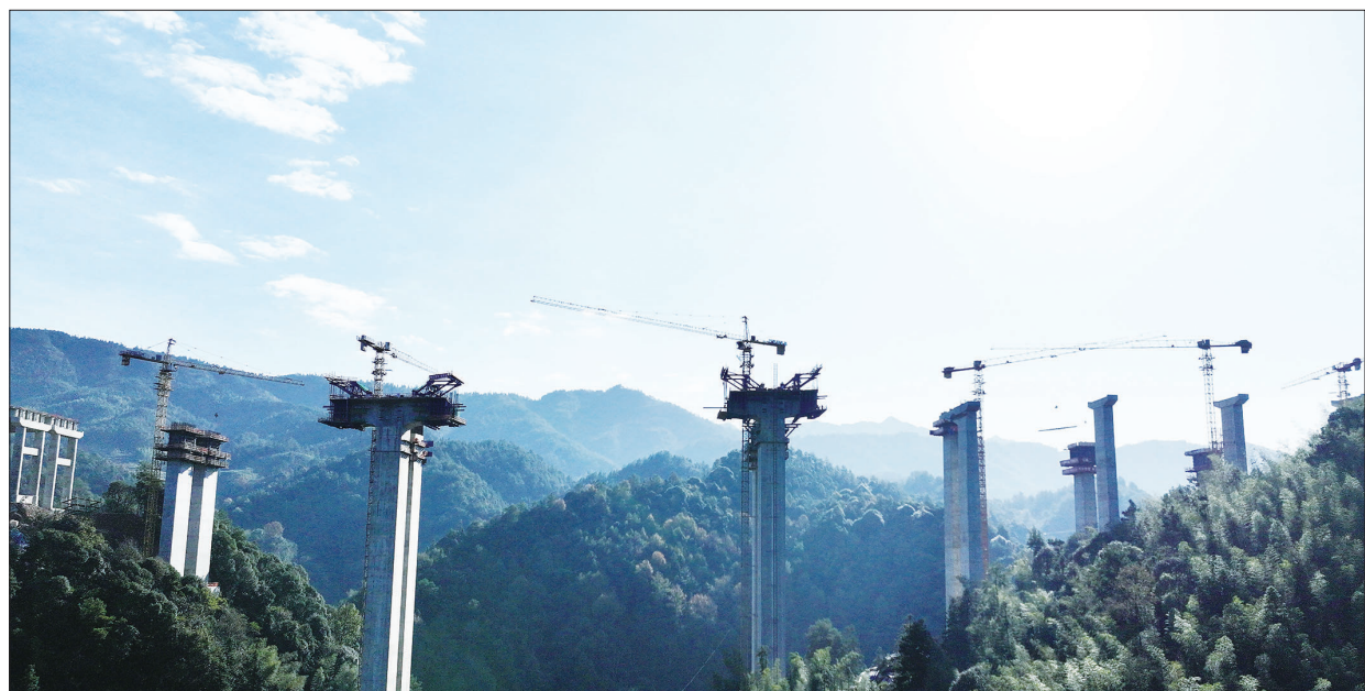
11月28日清晨,在城步苗族自治县丹口镇花龙村地段,城步至龙胜高速建设工地高大挺拔的桥墩与蓝天白云、青翠山峦相映成趣,壮丽如画。目前,城龙高速湖南段正全面加快建设,预计2025年国庆节前可实现通车。 严钦龙 摄
