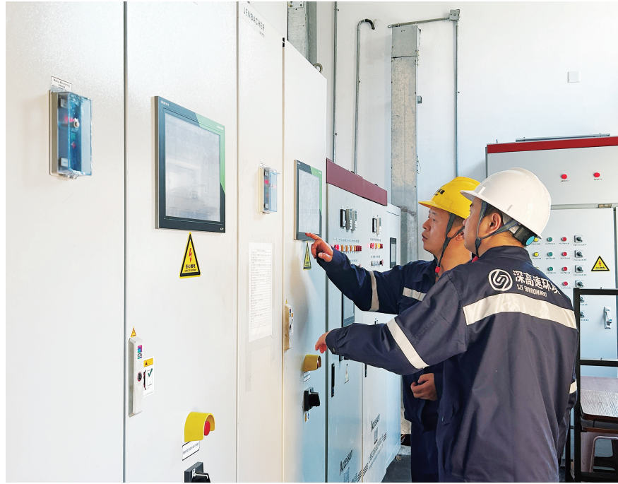
工作人员在沼气发电机房查看设备运行情况。
