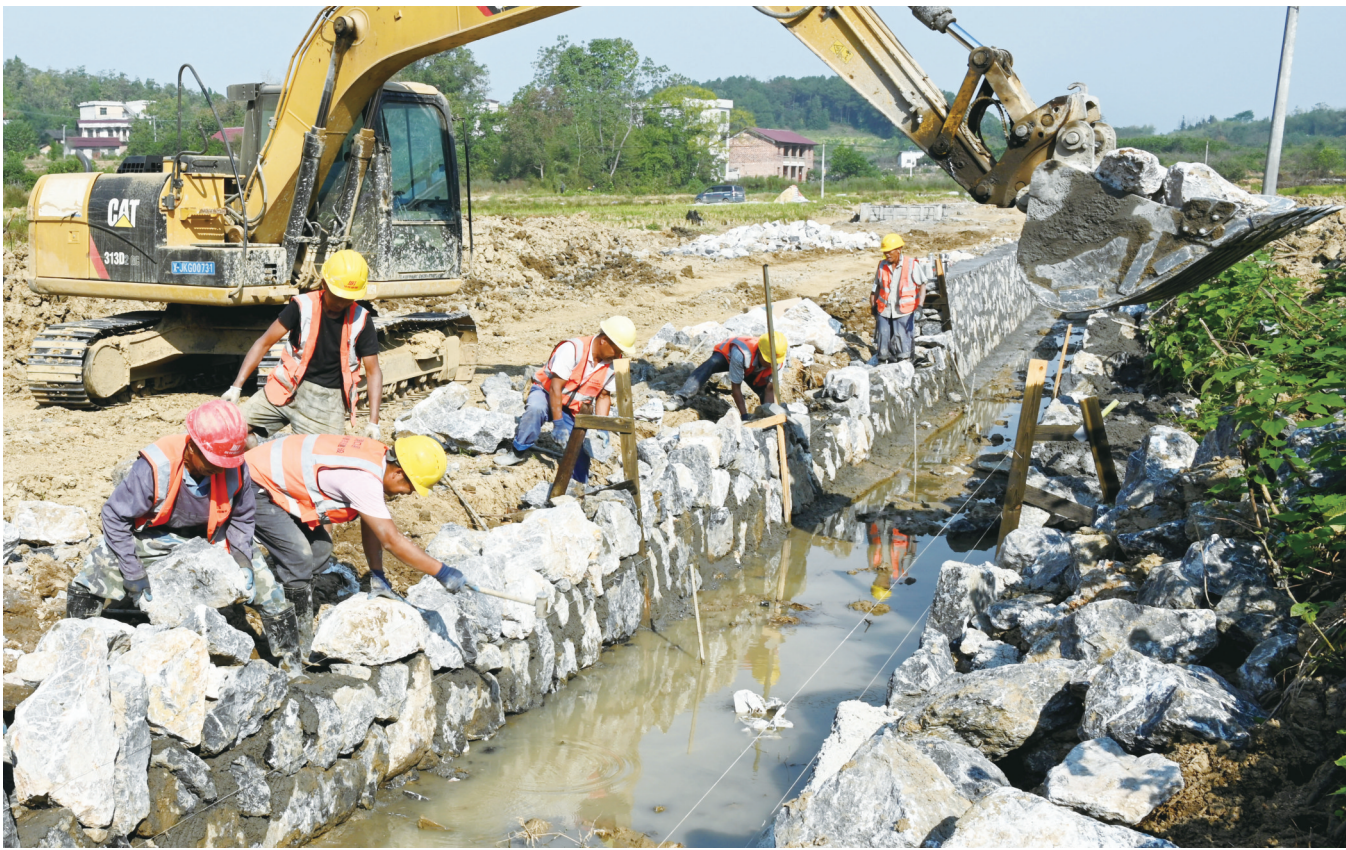
10月8日,洞口县高沙镇高沙村农田水利建设工地,工人在修建农田灌溉渠道。连日来,该县抓住秋季枯水期的有利时机,加大农田水利基础设施建设力度,推动中小型水库除险加固、高效节水灌溉工程等水利基础建设,为来年农业生产和防汛抗旱夯实基础。 滕治中 摄
