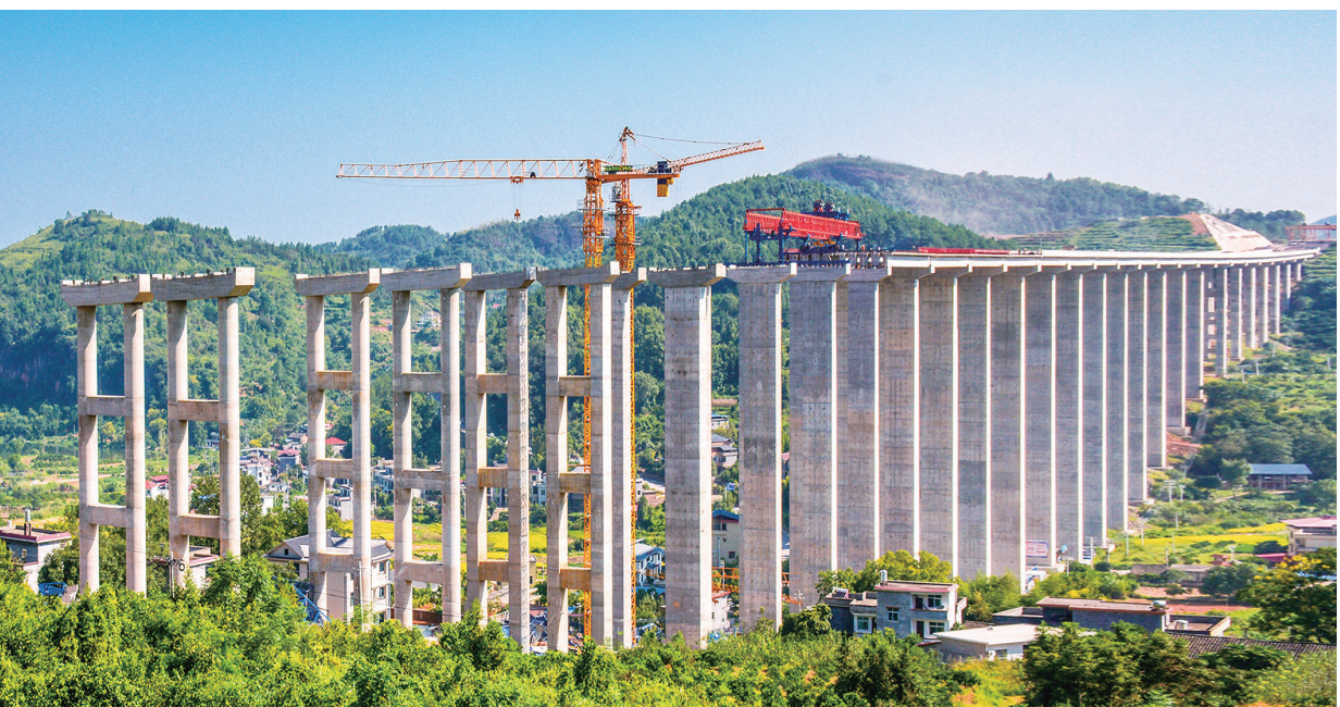
9月1日,新宁县清江桥乡赤木村新新高速公路二标段赤木特大桥墩上,工人们正在铺架桥面箱梁。该大桥是该标段跨度最长、桥墩最高的高架桥梁,全长1150米,墩高85米。当前,桥墩已全面完工,预计,桥面铺设箱梁将于9月底前竣工。郑国华 邓暄暄 摄影报道
