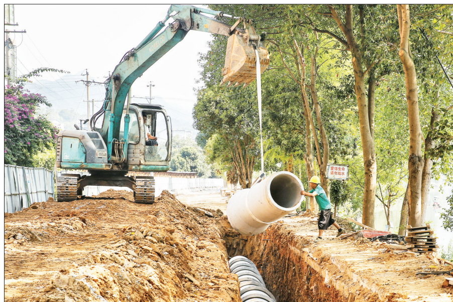
8月10日,绥宁县城区黄桑路地段正在进行管网施工作业,该县排污水管网改造项目有序推进。张贻华 摄
