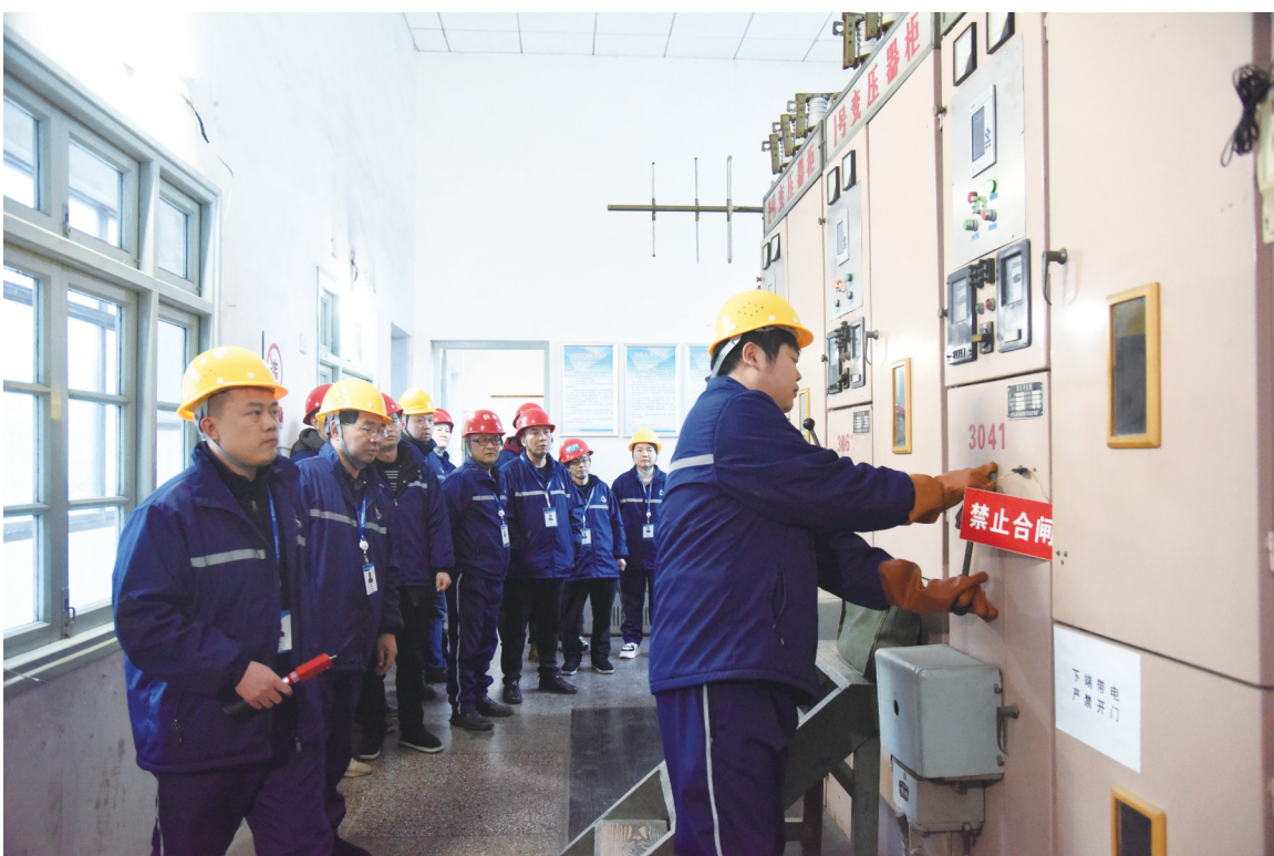
为进一步提高水厂停电响应效率和应急处置能力，保障春节期间供水安全，2月1日，市自来水公司在工业街水厂开展高压断电模拟应急演练。图为参演人员在高压配电室排查事故原因。邵阳日报记者 易蓝 通讯员 肖佳 摄影报道
