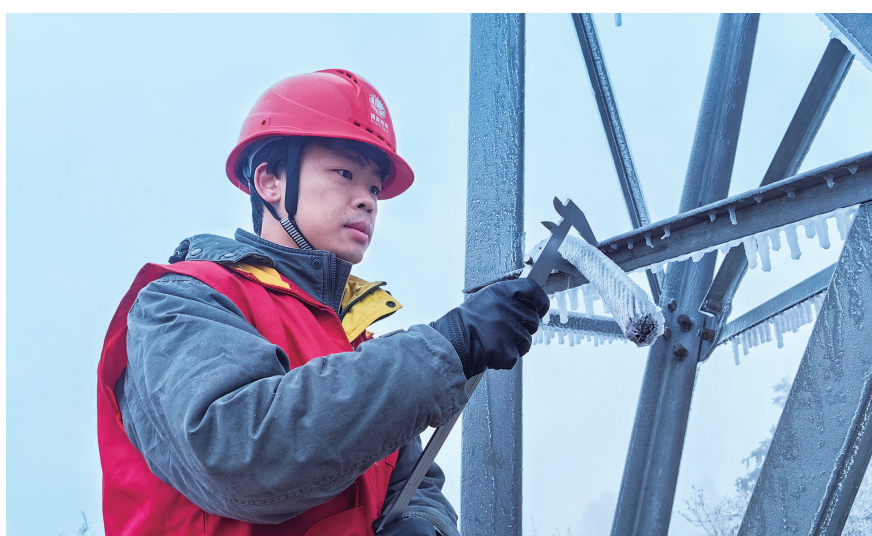
输电运检人员在观冰哨监测线路覆冰情况。
