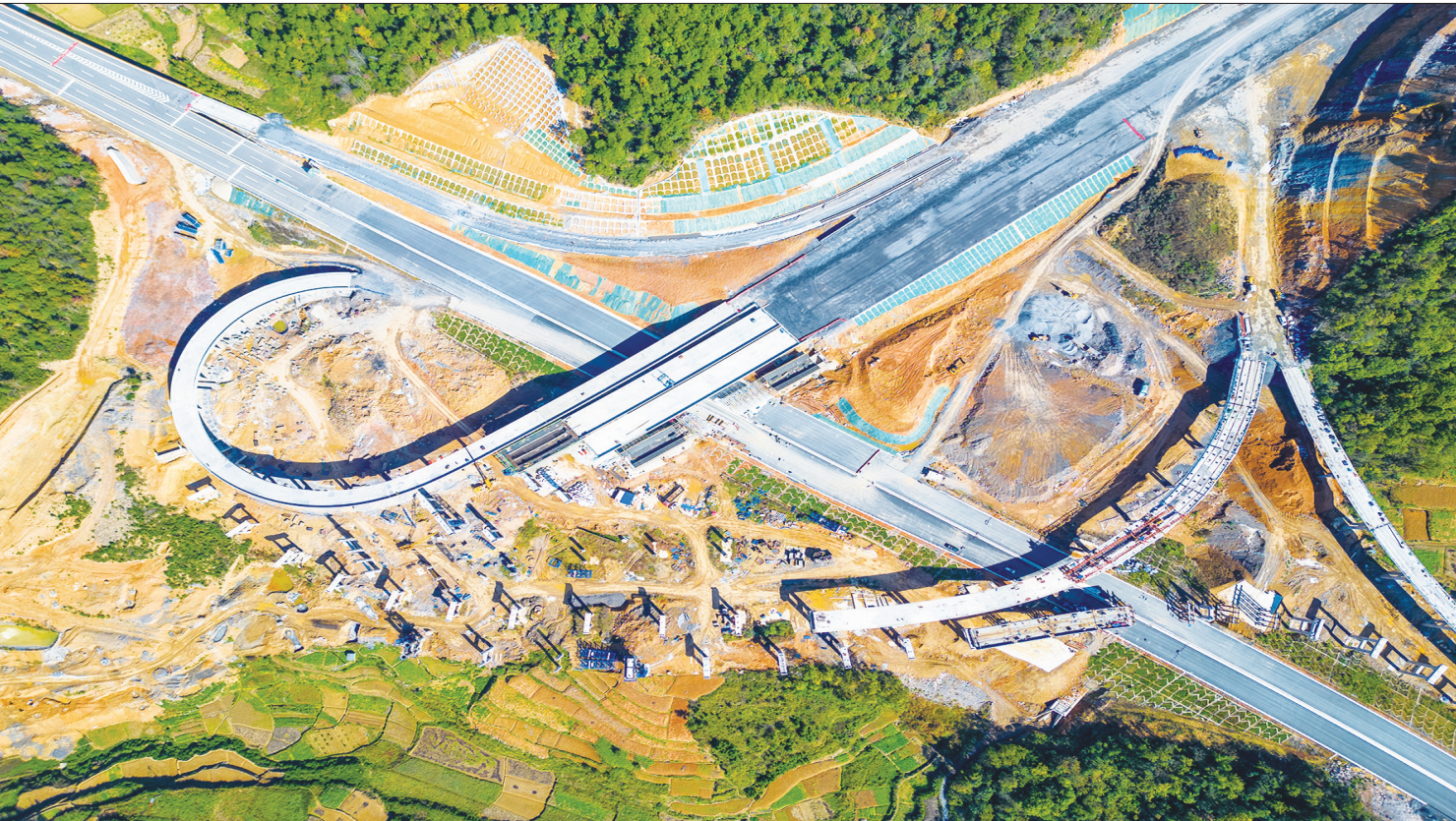
11月6日，新宁县回龙寺镇宝塔村地域，正在建设中的高速公路互通枢纽已具雏形。今年，该县在建永新高速、新新高速和已经建成通车的白新高速公路互通枢纽在这里连接。 郑国华 邓晓东 摄影报道
