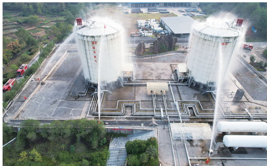
市消防救援支队组织开展化工灭火救援专业队拉动暨LNG罐车泄漏事故处置演练。
