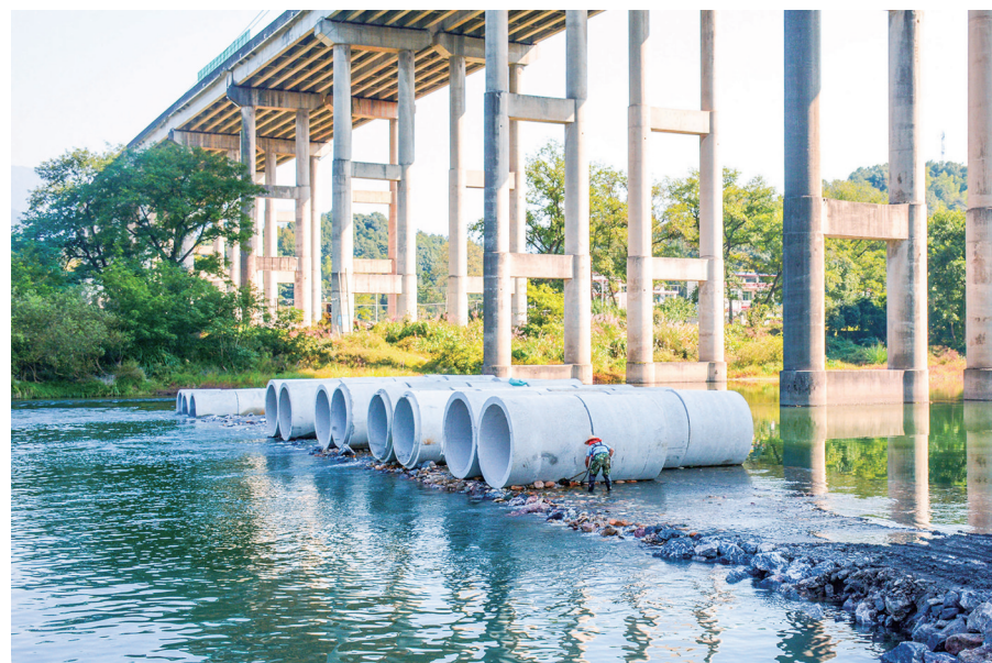
10月23日,新宁县金石镇连村崑山北大门便桥正在施工。该县规划从正在新建的新新高速公路县城互通枢纽至崑山北大门建设一条旅游引线公路,打造通往崑山景区的便捷旅游通道。
