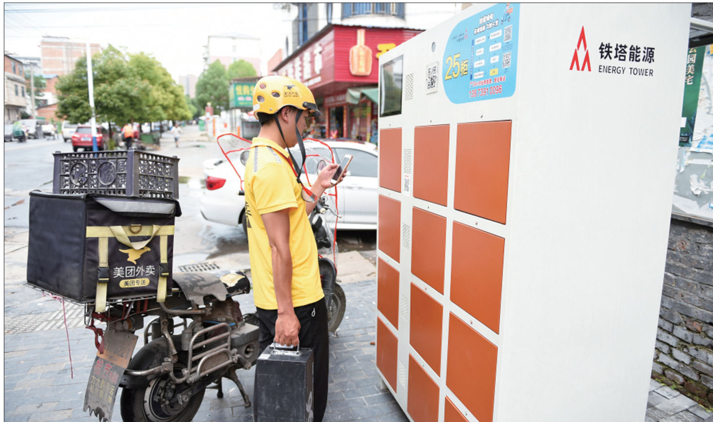
6月3日,市区迎春路上,外卖小哥余春晓正在换电柜更换电动车电池。据了解,目前在市城区有30多个电动车电池更换柜,此换电柜消除了外卖站点铅酸电池集中充电带来的安全隐患,为外卖骑手无限续航。针对住宅小区内大量电动自行车充电带来的安全隐患、续航里程短的问题,铁塔公司还将继续增加商圈与居民住宅区的覆盖范围,为广大市民提供更加安全、高效的电动自行车换电业务。邵阳日报记者 申兴刚 通讯员 伍妃梅 摄影报道
