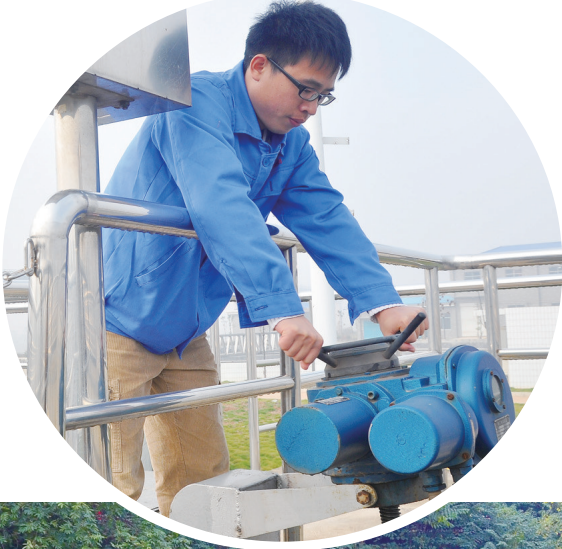
► 江北污水处理厂。 申兴刚 摄
