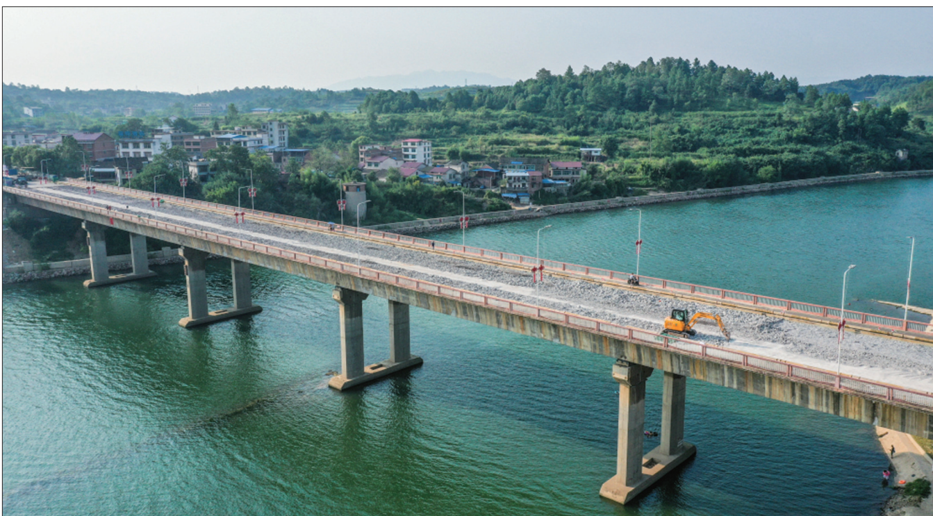
市区资江二桥全长538米，宽21.5米，属于四类危桥，加固改造项目总投资2386万元，工期150天。目前，引桥清理已经全部完成，正在进行桥面钢筋网制作，主桥面清理还剩余600余平方米，已经完成总投资的50%。预计10月底可完成桥面施工，11月底可全面恢复通车。图为8月22日下午，市区资江二桥施工现场。邵阳日报记者 申兴刚 摄
