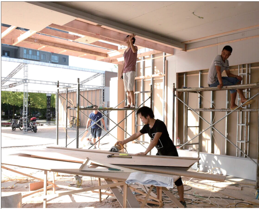
9月26日上午,施工人员在市区西苑公园广场装修交易展厅。9月29日,邵阳市第十三届房地产交易展示会将在此举行。杨敏华 摄
