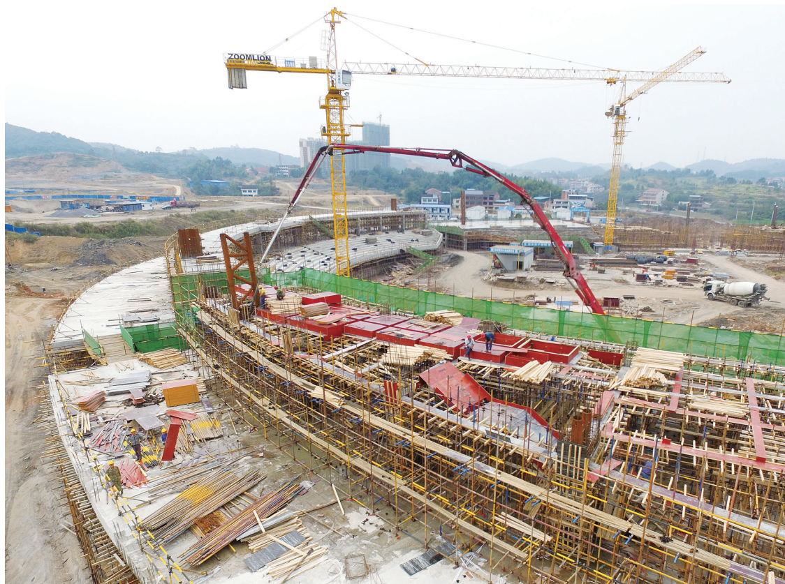
市体育中心新体育场目前已初具雏形，混凝土主体工程可望明年1月封顶，整个项目预计在2017年底竣工并交付使用。当前，每天有几百人在现场施工。 谢冰 摄
