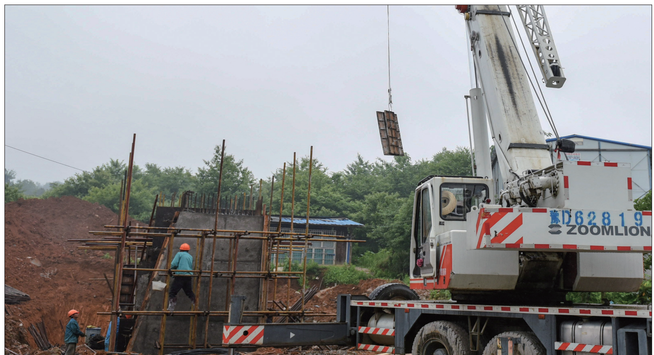
5月18日,施工人员正在位于隆回滩头镇的公跨铁立交桥桥墩撤膜。据了解,该桥为怀邵衡铁路怀化至衡阳段DK157+254.6处G320国道上跨铁路而建,桥上路面采用沥青路面,单幅桥面宽14m,桥梁全长82m。目前完成工程量的30%,预计8月底竣工。杨敏华 摄
